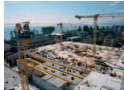
Construction du stade de la Maladière à Neuchâtel réalisé en partenariat public-privé.
